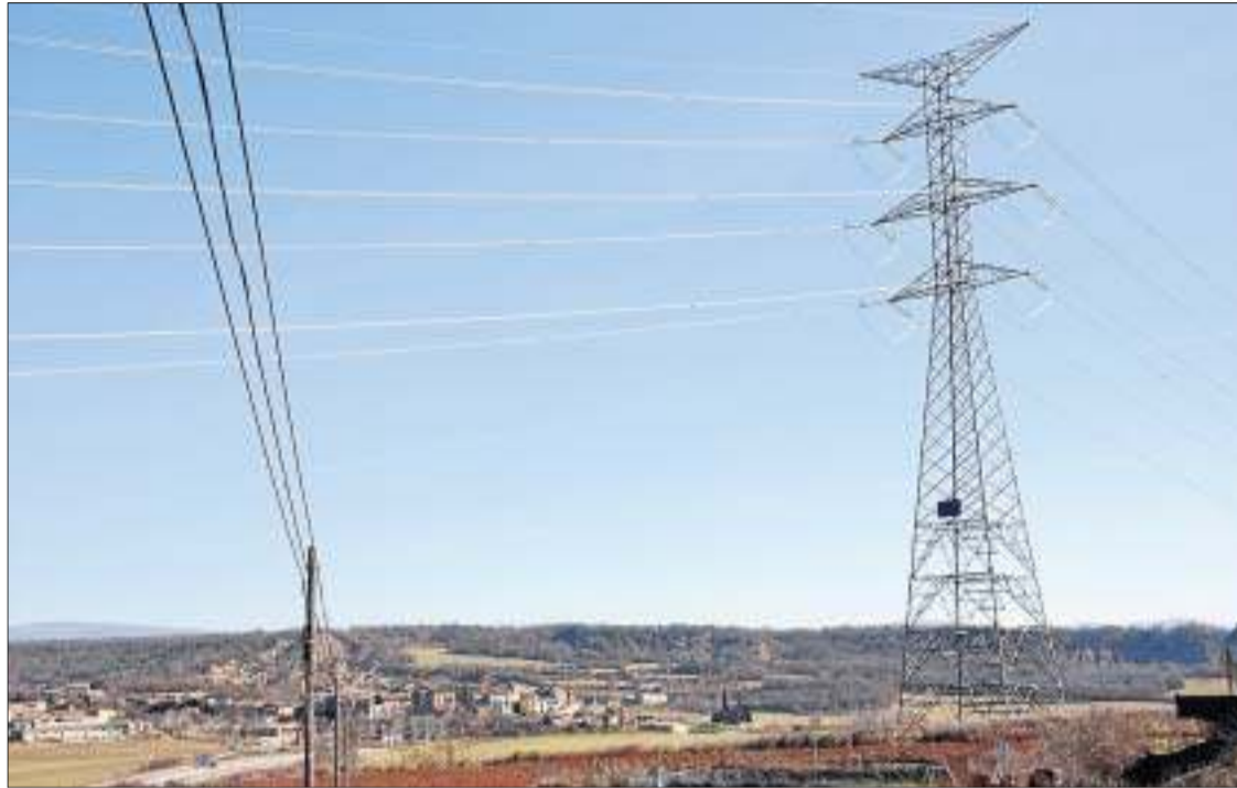
La zona de Figuerola d'Orcau on s'han expropiat els terrenys per a una subestació de la MAT.
